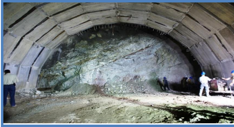
Figura 4.8. Frente de excavación del túnel 1 del P. H. La Yesca donde se aprecia la falla geológica “Colapso”.
