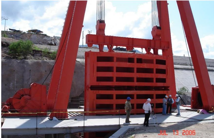
Figura 10.1 Compuerta de cierre final de CFE de 7 x 13 m y H = 170.00 m carga.
