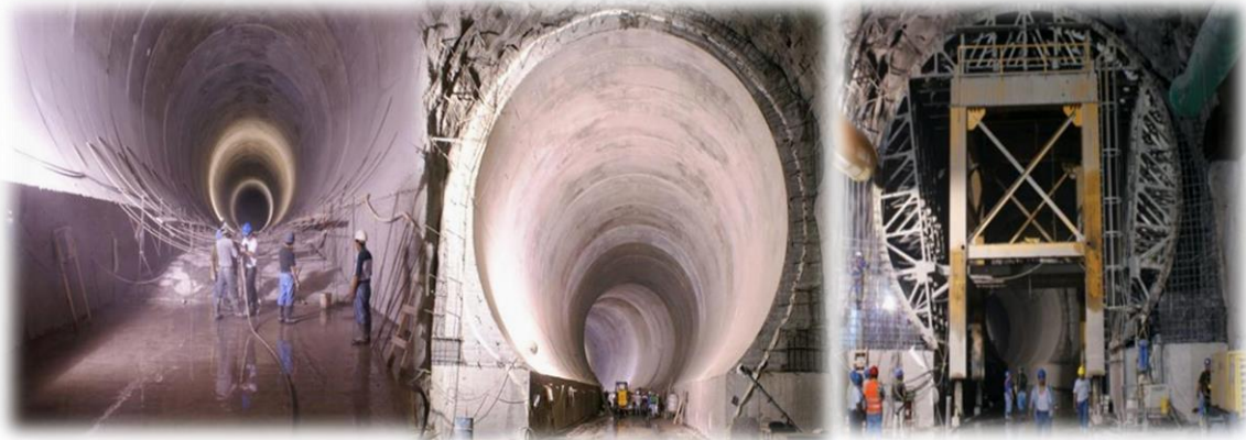
Figura 4.11b. Imágenes de las condiciones de construcción de los túneles donde se indica la construcción de casquillos y revestimiento de la obra de desvío del P. H. La Yesca.
