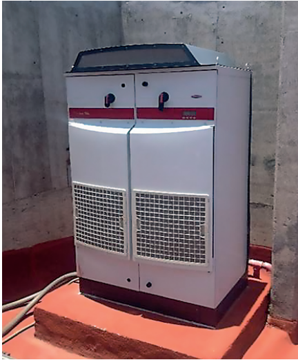
Figura 7.11. Equipo inversor marca Fronius para convertir de CD a CA, instalado en el SFVI de la ENES Unidad Morelia.
