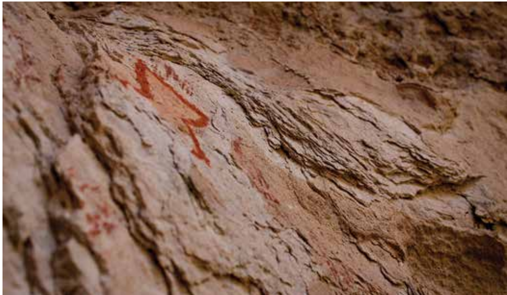
7. Deterioros en el principal panel pictórico, La Pintada, Sonora. Foto: Josué Cárdenas Pérez.
