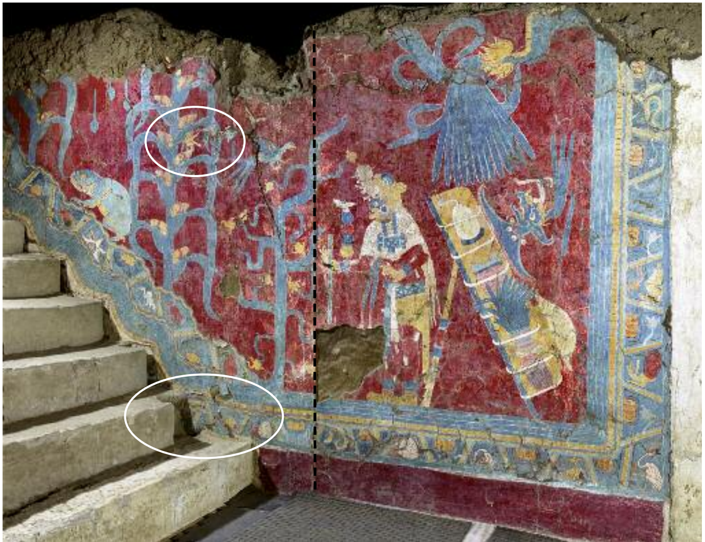
Figura 5.34. Templo Rojo, muro oriente. La línea de puntos marca la fisura vertical donde la pared se terminó originalmente; los diferentes materiales utilizados para construir la prolongación de la pared han causado esta separación. Los círculos marcan áreas donde la pintura de la serpiente y la cenefa original están visibles ahora. (Foto: R. Alvarado, 2008.)
