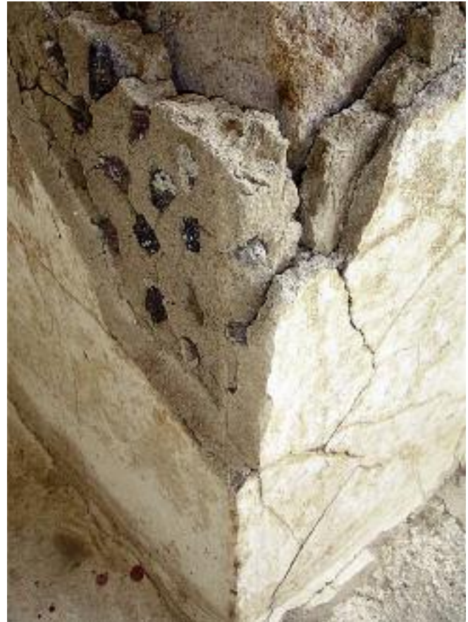
Figura 3.1. Técnica constructiva. El núcleo de tepetate se ve al centro. Está recubierto por una capa gruesa, que varía de 5 a 9 cm, de mezcla de lodo y cargas duras que conforman lo que se llama el firme. El firme tiene la función de homogenizar el muro de tepetate. Sobre éste se incrustaron piedras repartidas uniformemente en toda su superficie, así el firme puede recibir las siguientes capas de repellado. La primera es un mortero de cal y cargas duras de color gris que mide entre 1 y 2 cm; la segunda, es el enlucido fino que es blanco y representa el acabado final. Los enlucidos miden hasta 1 cm. (Foto: D. Magaloni, 2008.)
