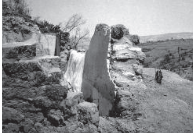
Figura 4.25. Vista lateral del muro oriente del Edificio A. Puede verse el desplome del muro y la disgregación del núcleo arcilloso, que requirió una intervención estructural para evitar su caída. (Foto: R. Peralta, marzo de 1976. Fototeca CNCPC-INAH.)
