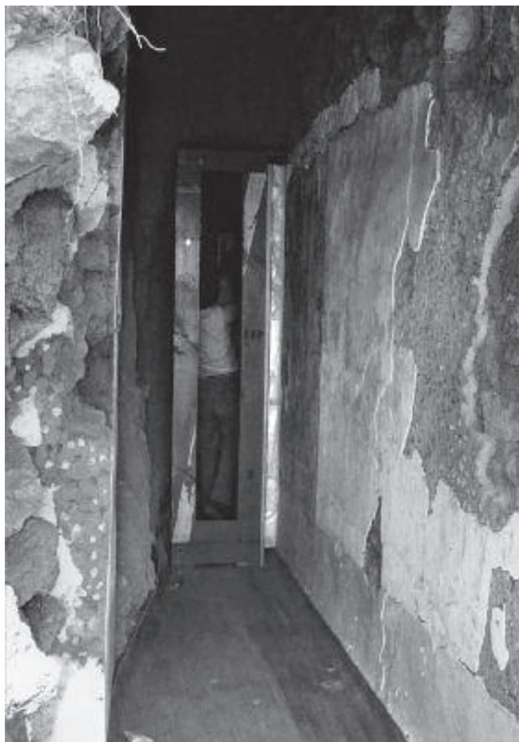
Figura 4.22. Cavidad que hicieron los saqueadores para entrar en el edificio; se ve el boquete y los daños en los elementos constructivos. Al fondo del pasillo se comienza con la protección del mural para poder continuar con las excavaciones. (Foto: R. Peralta, noviembre de 1975. Fototeca CNCPC-INAH.)
