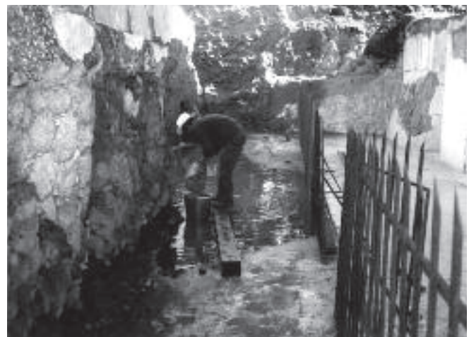
Figura 4.74. Trabajos de desalojo de agua pluvial con cubetas, en un encharcamiento frente al Edificio A. (Foto: R. Peralta, agosto de 1976. Fototeca CNCPC-INAH.)
