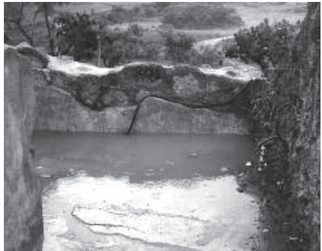
Figura 4.97. Inundación por las lluvias en un cuarto del Gran Basamento. (Foto: R. Peralta, agosto de 1976. Fototeca CNCPC-INAH.)
