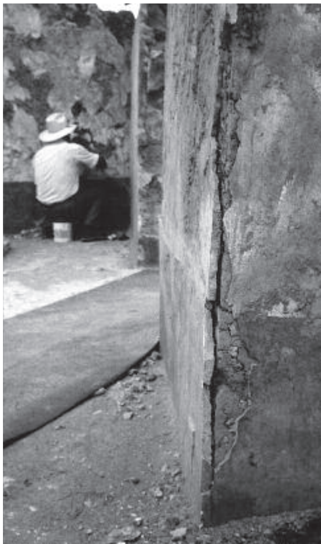
Figura 4.29. En la pilastra del centro puede apreciarse el desprendimiento del aplanado. (Foto: R. Peralta, junio de 1976, Fototeca CNCPC-INAH.)
