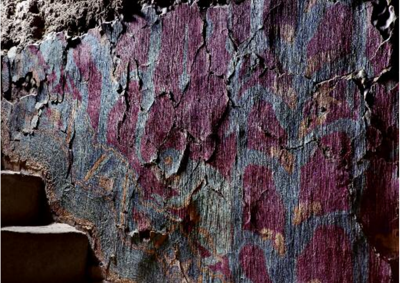
Figura 3.3. Templo Rojo, muro oriente. Con la luz rasante podemos apreciar, además del estado fragmentario del mural, la textura rugosa, vertical del enlucido fino que recibe las capas de color. Esta textura afecta visualmente a la pintura mural. (Foto: R. Alvarado, 2008.)
