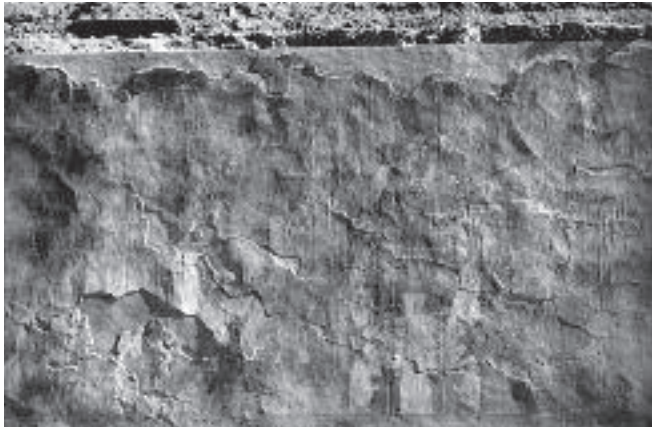
Figura 4.26. Pintura mural de La Batalla, segmento del muro poniente en el que pueden apreciarse los abombamientos y la pérdida de plano del aplanado sobre el que se realizó la pintura. (Foto: I. Groth, agosto de 1976. Fototeca CNCPC-INAH.)
