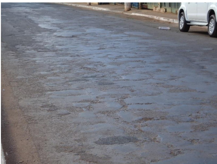
Figura 4. Remendos no Trecho 01
