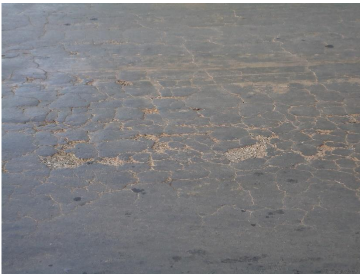
Figura 3. Trinca interligada tipo couro de jacaré com erosão no Trecho 01
