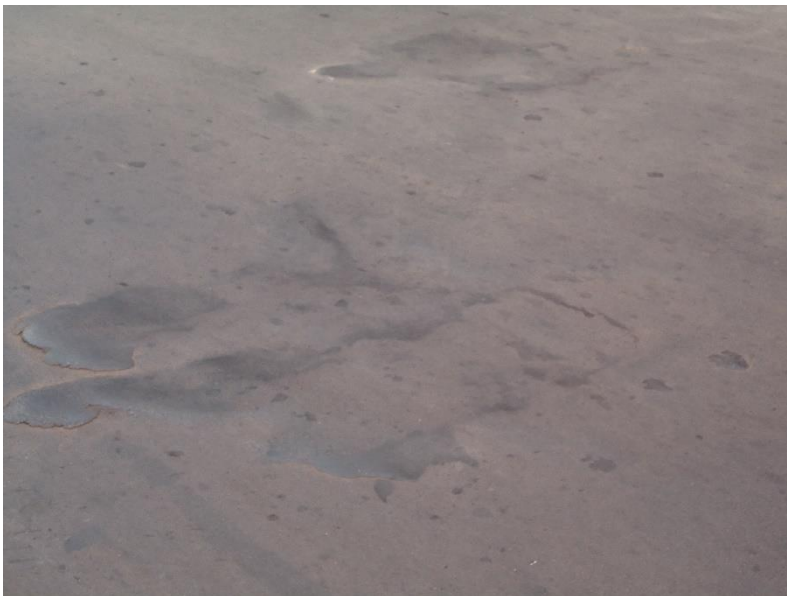
Figura 7. Escorregamento no Trecho 04
