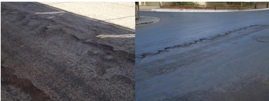
Figura 5. Desgaste ou desagregação nos Trechos 01 e 05
