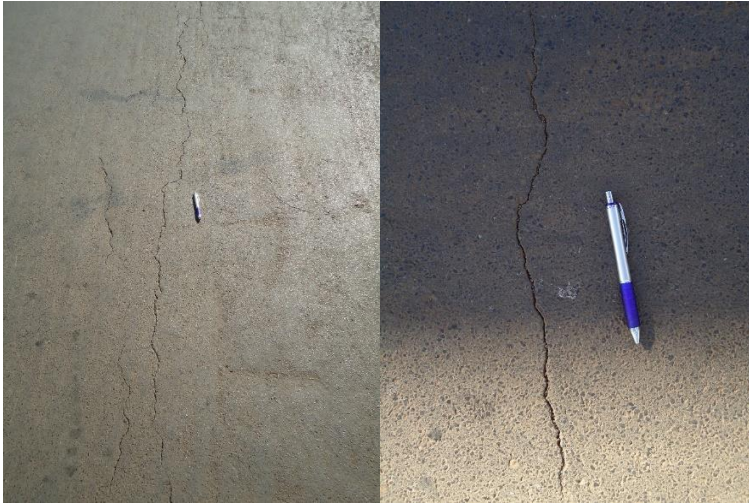
Figura 2. Trincas isoladas no Trecho 03
